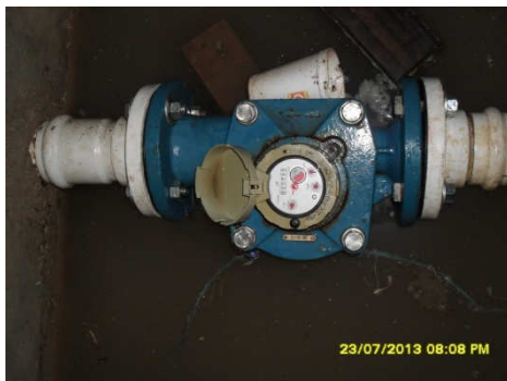
Instalación de medidores secundarios
